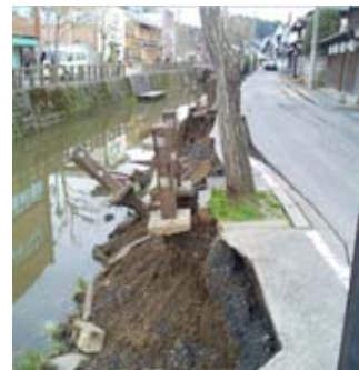
小野川護岸の崩壊
